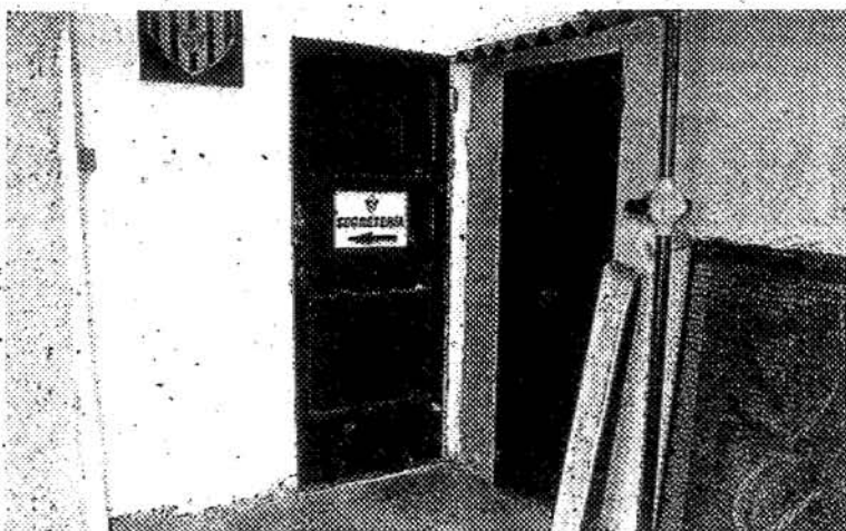
La porta degli spogliatoi della Lavagnese danneggiata
